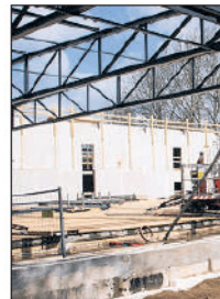
Die Runderneuerungsarbeiten um das alte Edelstahlbecken herum sind deutlich erkennbar. Foto: Hanko
